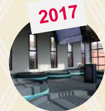
Mise en service des volants d'inertie
